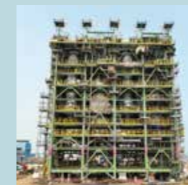
Process Modules (PAU)
